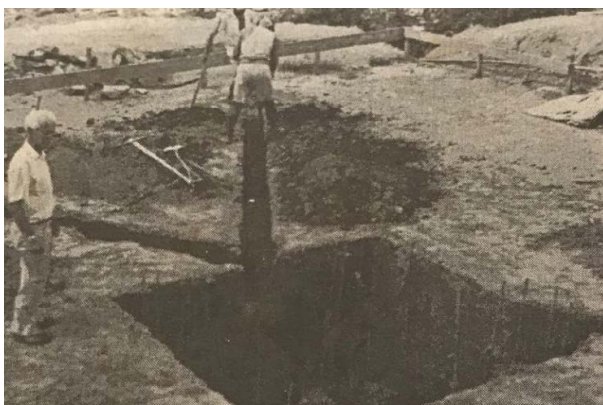
Figura 5. Registro das obras de fundação do monumento. Fonte: Folha da Mata, ano XXXIII, nº 1410, 09/03/1996.
